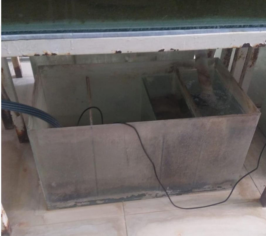
Şekil 3.14 Akvaryum ünitesinde bulunan SUMP filtrelerden biri
