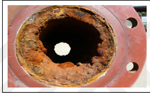
Şekil 1.6 Bir boru hattı içindeki mikrobiyal korozyon (Alajaili, 2016)
