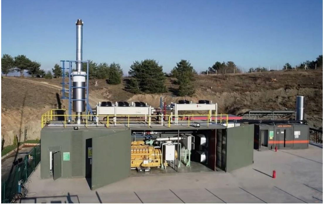
Şekil 3.3 Kastamonu ili deponi gazı elektrik üretim tesisi
