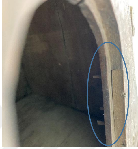
Resim 5.4 Eserin kaide bölümünde yer alan girintili bölümün sol kısmında tespit edilen metal unsurlar
