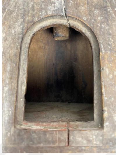
Resim 5.10 Eserin kaide bölümünün arkasında yer alan iç boşlukta görülen toz, kir ve lekelenmeler
