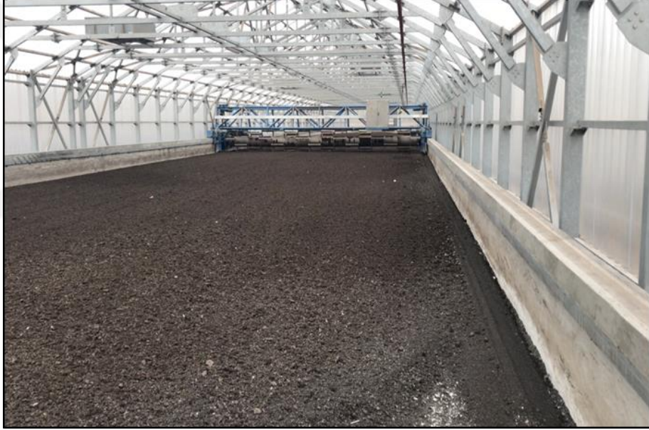
Şekil 3.1 Solar çamur kurutma ünitesi, çamur örtüsü (fotoğraf yazar tarafından çekilmiştir)
