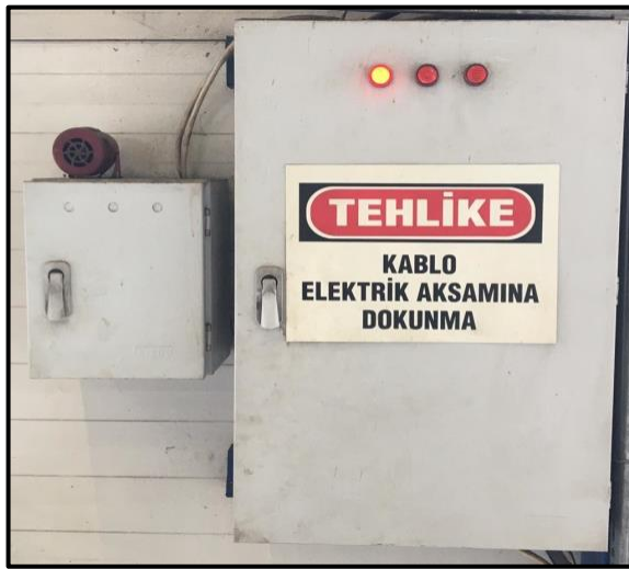
Resim 4. 13 Elektrik Panosu Uyarı Levhası
