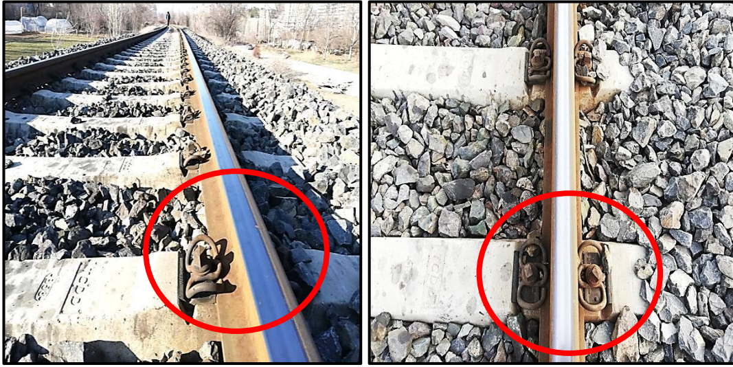
Resim 1.2 Ray Bağlantı Elemanlarının Demiryolu Üzerindeki Görünümü
