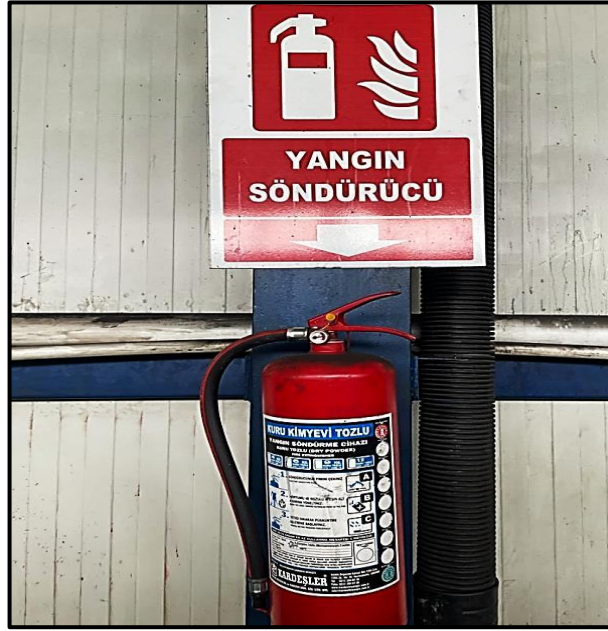
Resim 4. 11 İmalat Bölümünde Yer Alan Yangın Tüpü
