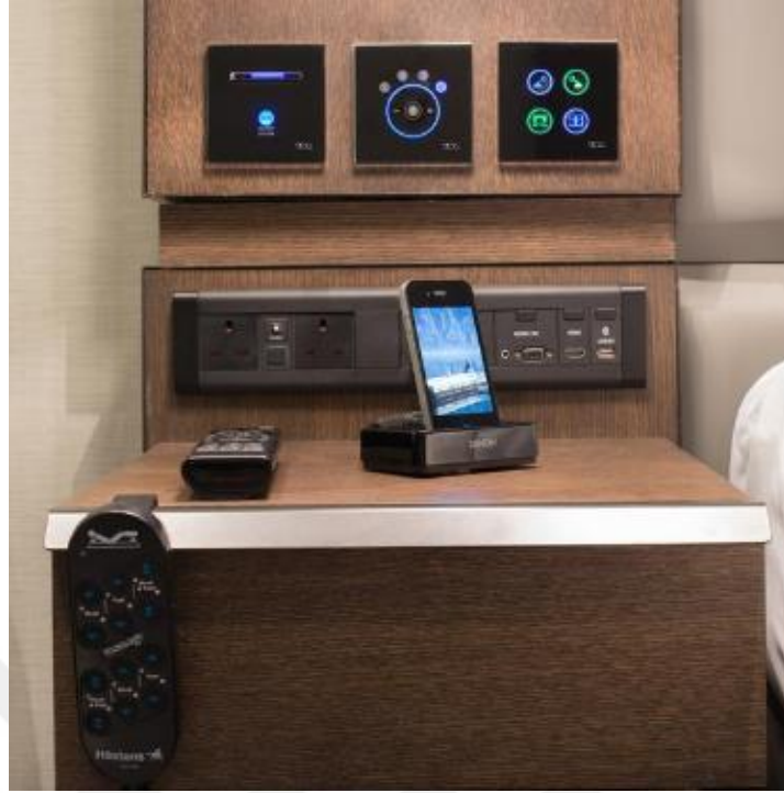
Fotoğraf 8. Oda İçindeki Kontrol Paneli
