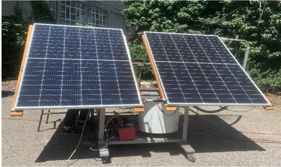
Şekil 3.4 Fotovoltaik modüller (FV modülleri)
